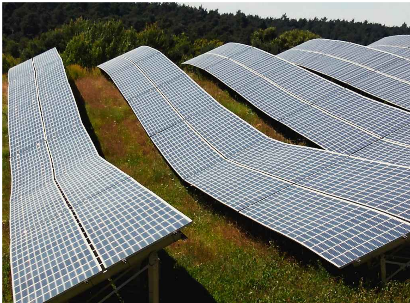
Auch der Landkreis Miltenberg baut auf die Kraft der Sonne. Das zeigt die neue Fotovoltaikanlage auf der ehemaligen Klärschlammdeponie in Schippach. Langfristiges Ziel des Bundes Naturschutz ist es, dass die Region ausschließlich erneuerbare Energien nutzt. Foto: Martin Bachmann
